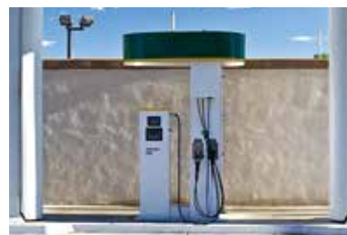
水素ステーション
